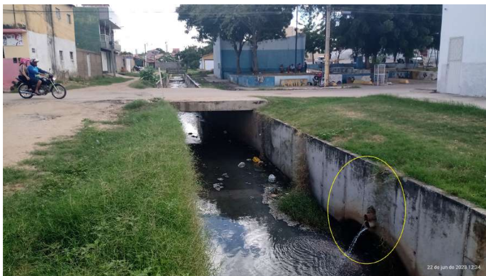
Foto 05: Rua José Marlon Alves Amaro, Bairro Noé Trajano, Patos/PB. Esgotos sanitários residenciais ligados ao canal. Fluxo exclusivo de esgotos sanitários no canal. 22/06/2023.
