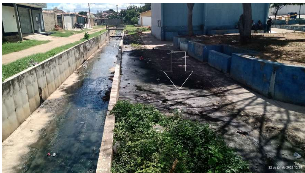
Foto 07: Rua José Marlon Alves Amaro, Bairro Noé Trajano, Patos/PB. Esgotos sanitários residenciais escoando pelas bordas do canal. 22/06/2023.
