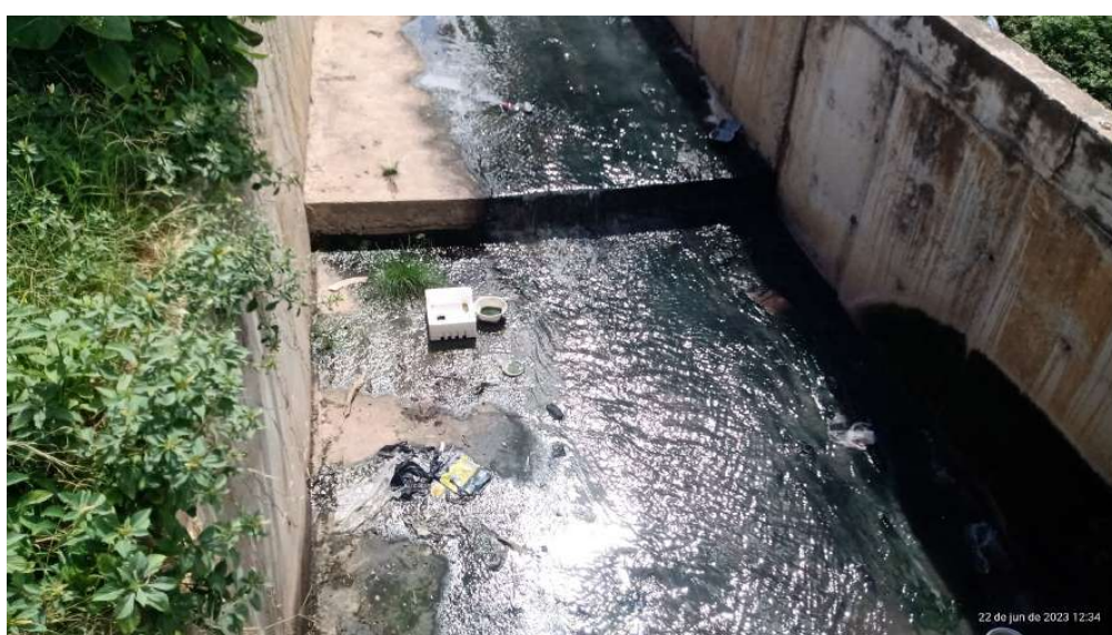
Foto 06: Rua José Marlon Alves Amaro, Bairro Noé Trajano, Patos/PB. Esgotos sanitários residenciais ligados ao canal. Fluxo exclusivo de esgotos sanitários no canal. 22/06/2023.
