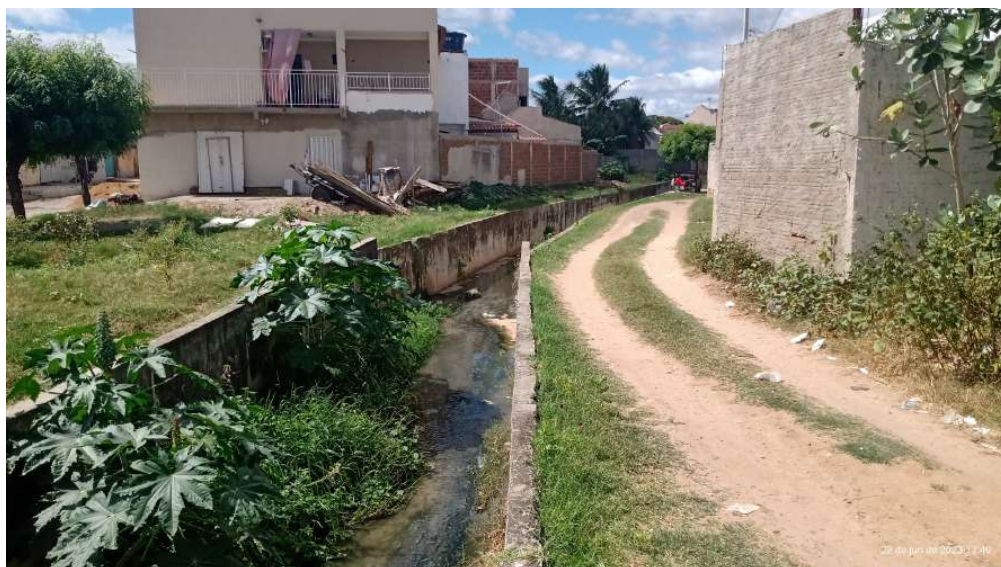
Foto 11: Rua José Marlon Alves Amaro, Bairro Noé Trajano, Patos/PB. Crescimento de vegetação no interior do canal. 22/06/2023.
