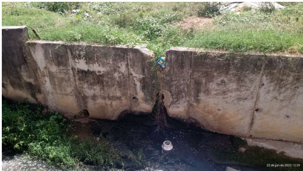
Foto 10: Rua José Marlon Alves Amaro, Bairro Noé Trajano, Patos/PB. Esgotos sanitários residenciais ligados ao canal. Despejos indevidos de efluentes. 22/06/2023.
