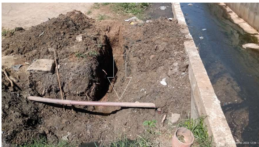
Foto 09: Rua José Marlon Alves Amaro, Bairro Noé Trajano, Patos/PB. Esgotos sanitários residenciais com ligação recente para o canal. 22/06/2023.
