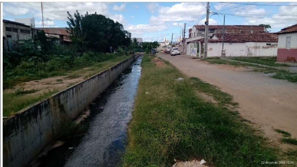
Foto 02: Rua José Marlon Alves Amaro, Bairro Noé Trajano, Patos/PB. Esgotos sanitários residenciais ligados ao canal. Fluxo exclusivo de esgotos sanitários no canal. 22/06/2023.
